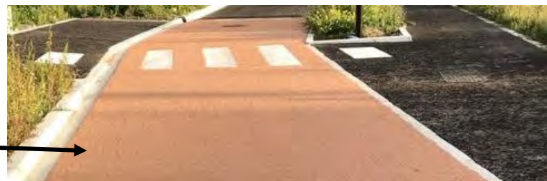
Exemple de revêtement roulant (résine) permettant de marquer au croisement d'une chaussée véhicule la continuité de la voie lyonnaise et de la faire comprendre aux autres usagers de la chaussée.
